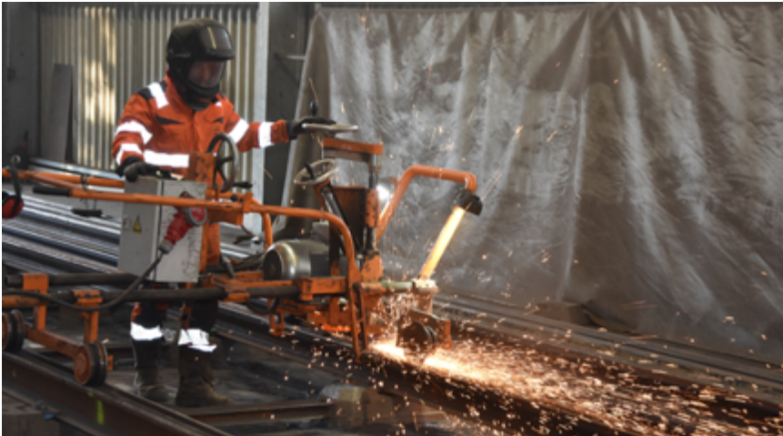
Opération de meulage de rail au sein de l'atelier d'Electrofer à Quédillac en septembre dernier.
